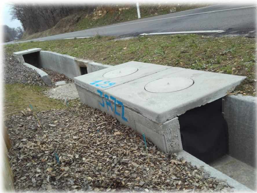
Le passage à petite faune de la Réserve Naturelle de Saint Bonnet
